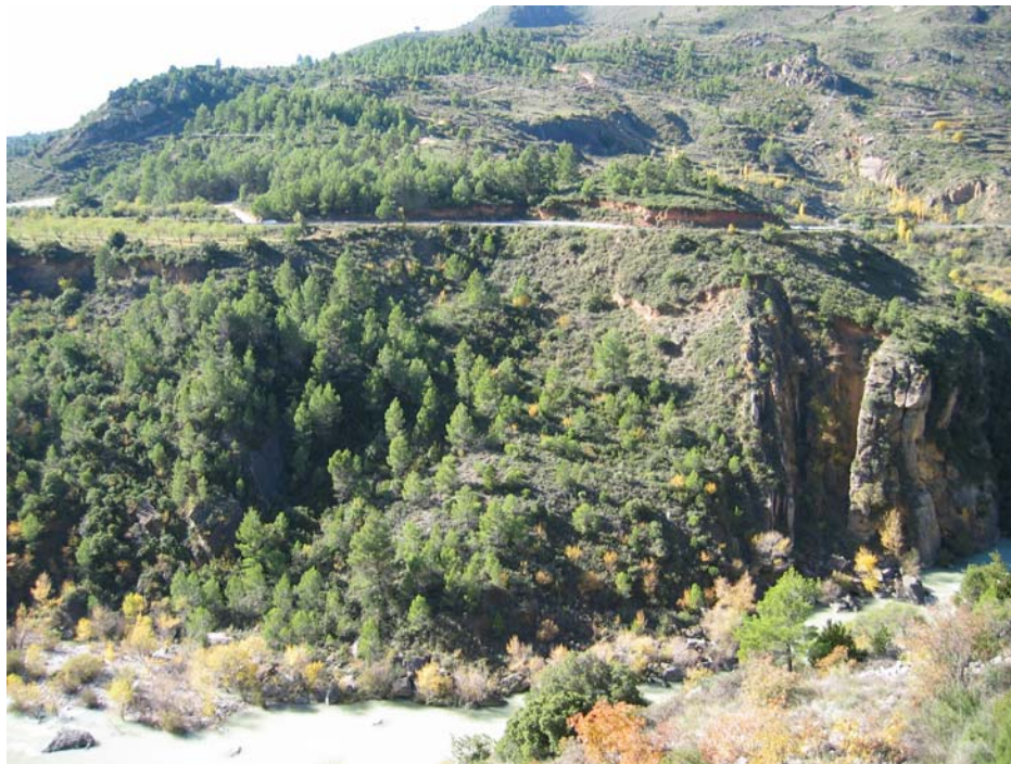
Foto 7.9. Deslizamiento del sustrato confinado por planos de estratificación en el punto de coordenadas 686.5-4692.0.
